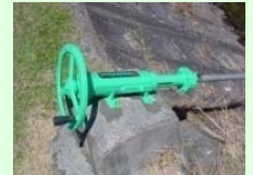
ゲート、バルブの更新
