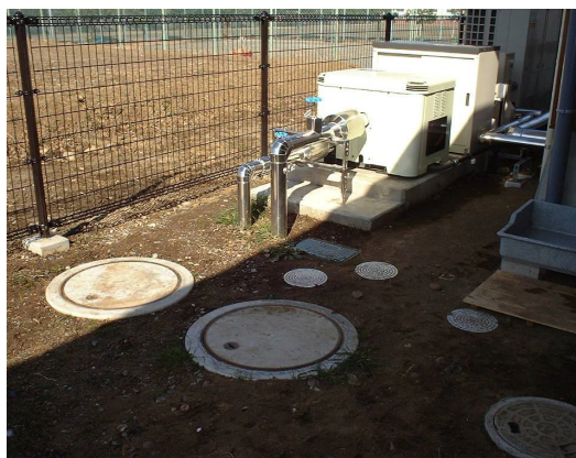
◆環境学館いずみ雨水再利用設備
