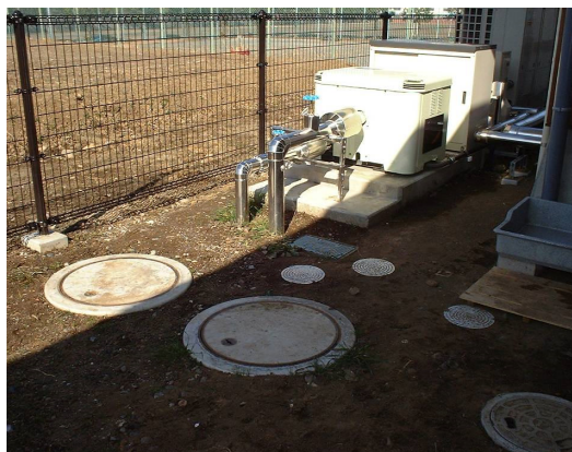
◆環境学館いずみ雨水再利用設備
