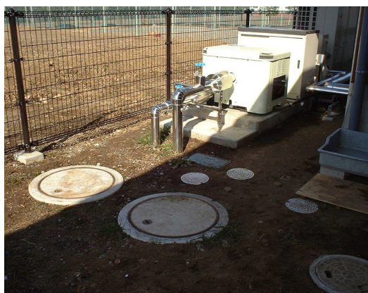
◆環境学館いずみ雨水再利用設備
