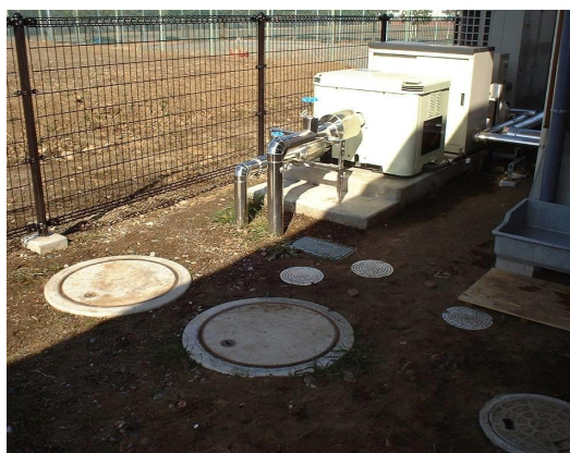
◆環境学館いずみ雨水再利用設備
